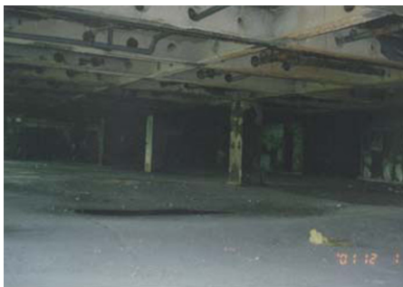
(d) Large deflection in the floor slab
